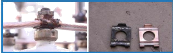
变电站电接触腐蚀情况
