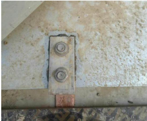
新东北电气集团接地铜排（2016年10月）
