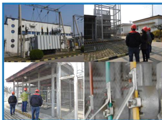
2017年现场回访--无腐蚀、无发热
