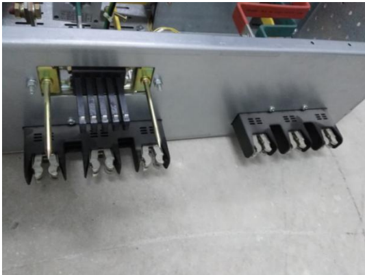
北京科锐配电柜（2016年12月）
