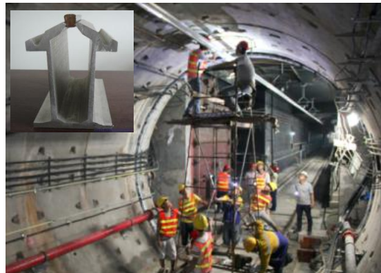
中铁电气化局-南昌2号（2017年1月）
