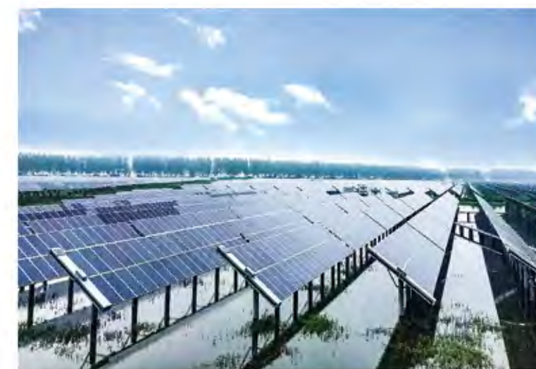
项目地: 国电投沧州 容量: 280MW 解决方案: 渔光互补项目
