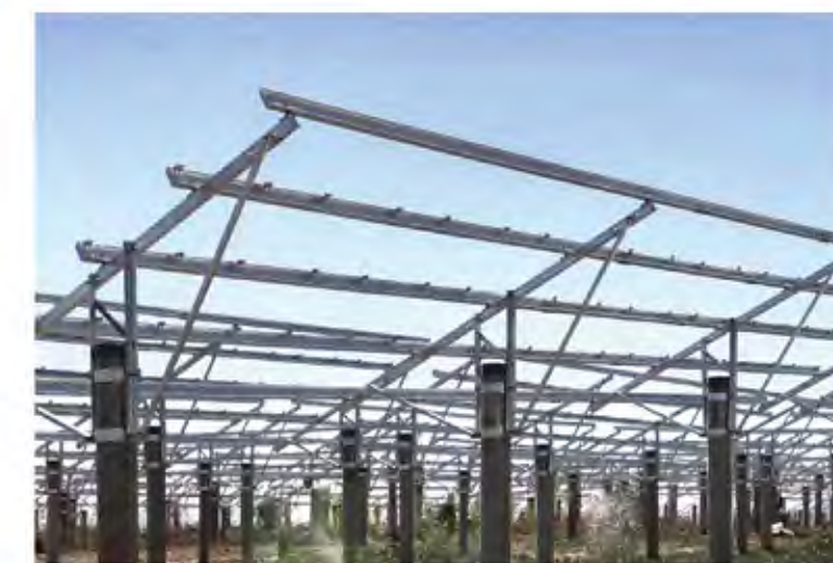
项目地: 隆基陕西 容量: 260MW 解决方案: 固定式支架系统
