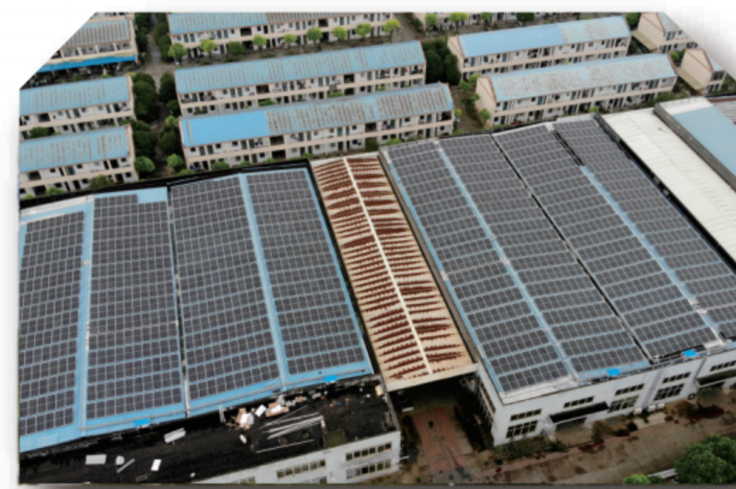
山东屋顶光伏项目 (5MW) Roof Top PV Project in Shandong
