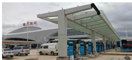
江西赣州西高铁站充电站
