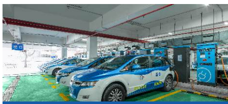
深圳清水河电动汽车充电站
