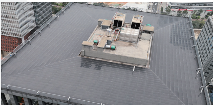
■ 北京理工大学深圳研究生院高层建筑屋顶光伏电站
