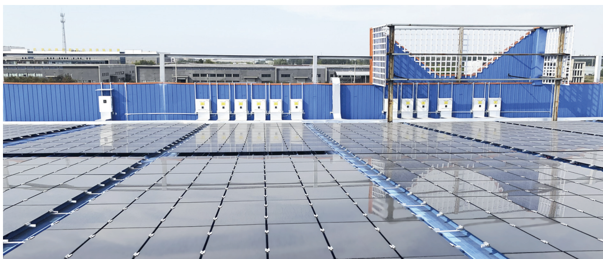
■ 润昌2.3MW屋顶光伏电站
