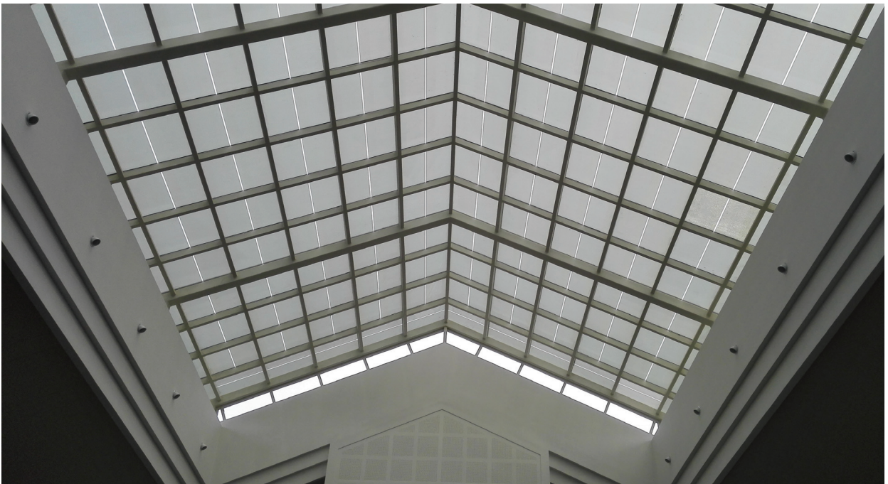
天津养老院CdTe光伏透光屋顶电站
