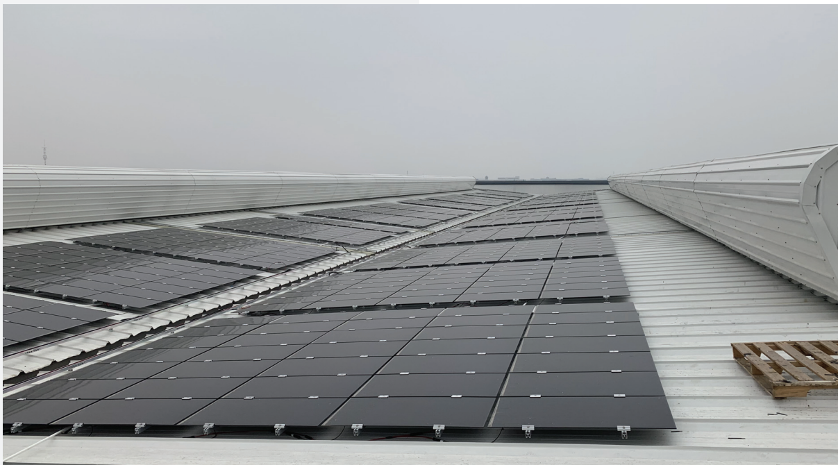
■ 新吉奥5.4MW屋顶光伏电站
