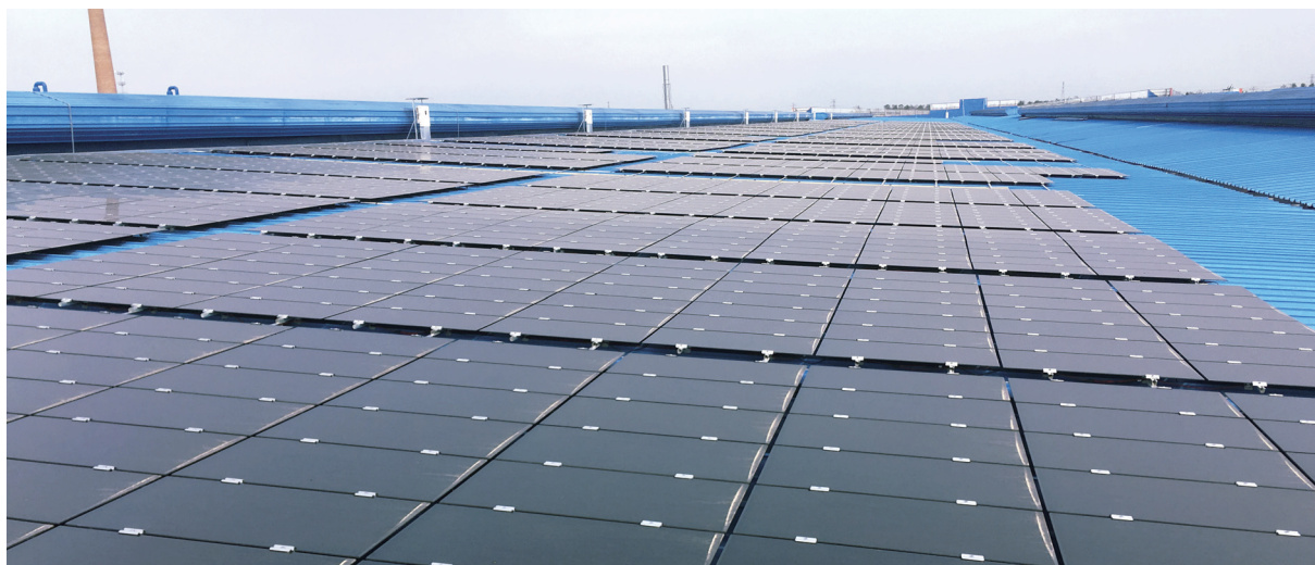
■ 聚润2.4MW屋顶光伏电站
