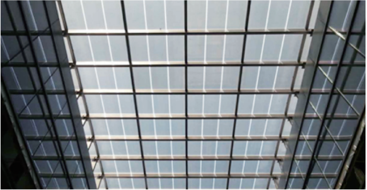
北京联想总部大厅CdTe光伏透光屋顶电站
