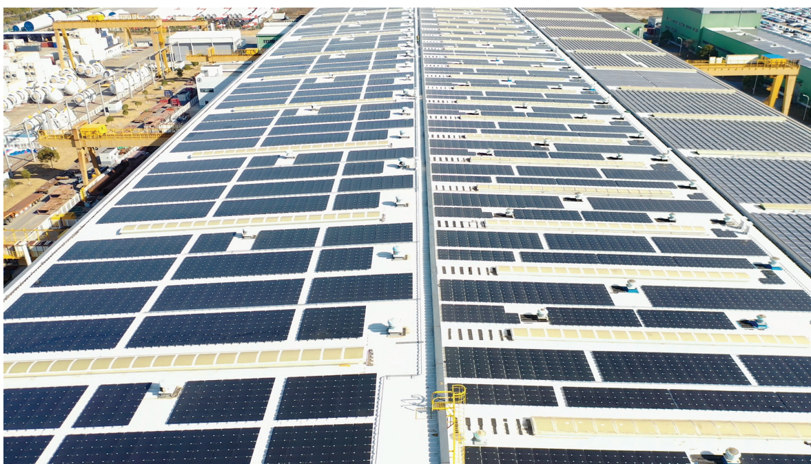
上海电气2.5MW屋顶光伏电站
