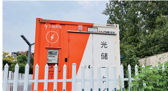
杭州某光储充储能项目
