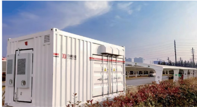
西安某光储充储能项目
