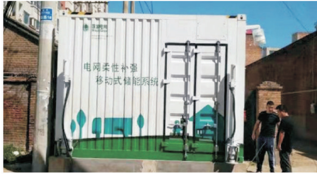
雄安某移动储能项目
