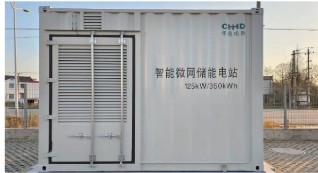
扬州某光储充项目
