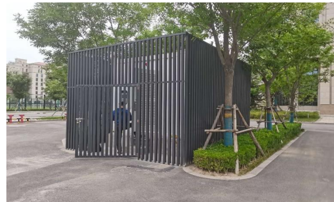
隆基交大创新港光储充微网项目
