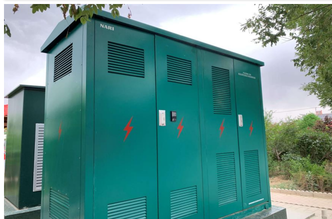
宁夏固原低压柔性台区互联项目
