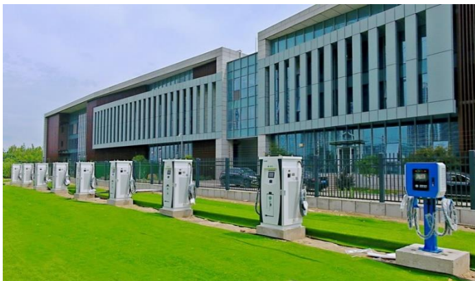
杭州萧山直流配电项目
