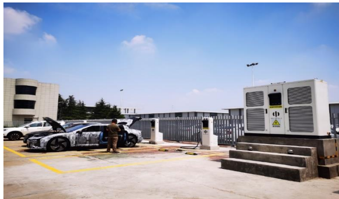
华人运通盐城厂区储充微网项目
