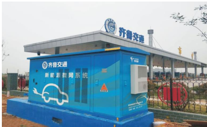
齐鲁交通微电网项目
