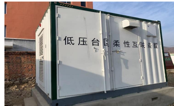
秦皇岛低压柔性台区互联项目
