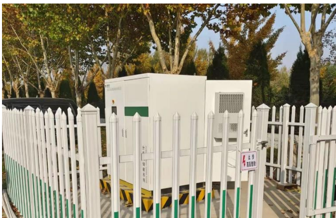
山东电工分布式储能项目
