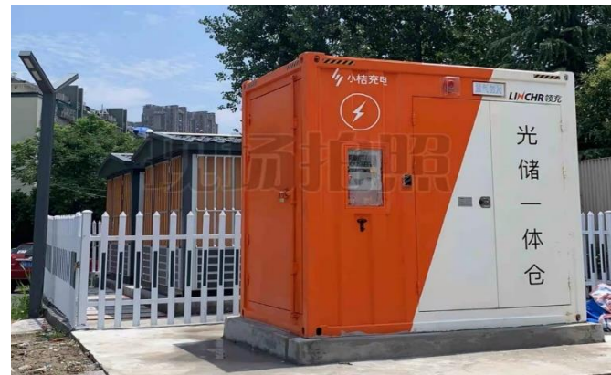
杭州小桔光储充项目
