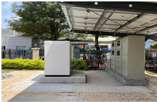
厦门同安分布式储能项目
