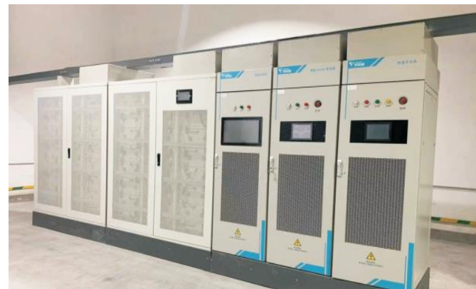
西安沣西新城储能项目
