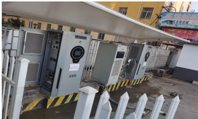
云南电网玉溪综合能源站项目
