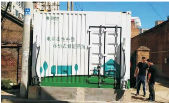
雄安/福建移动储能项目
