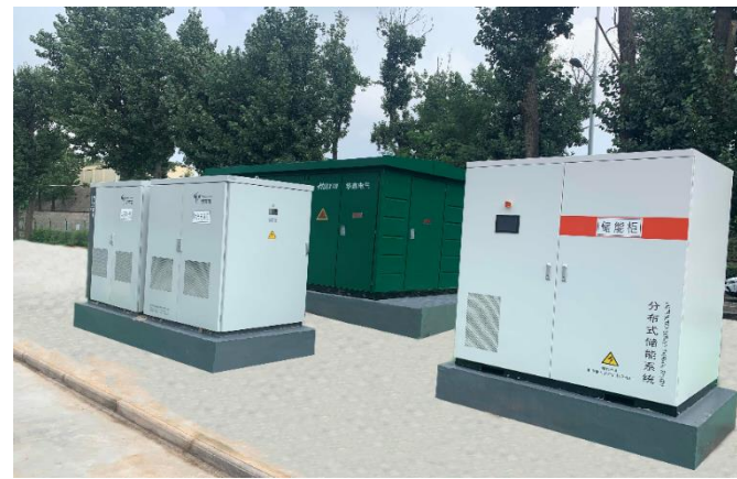
山西阳泉分布式储能微网项目
