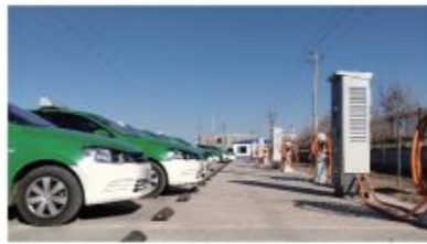
内蒙古通辽市奈曼旗公交充电站
