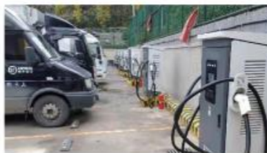
顺丰速递(贵州)充电站
