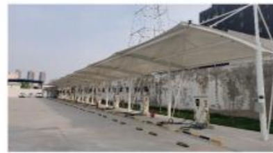
开封市尉氏县金运公交充电站
