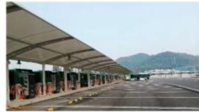
浙江德清公交客运中心充电站
