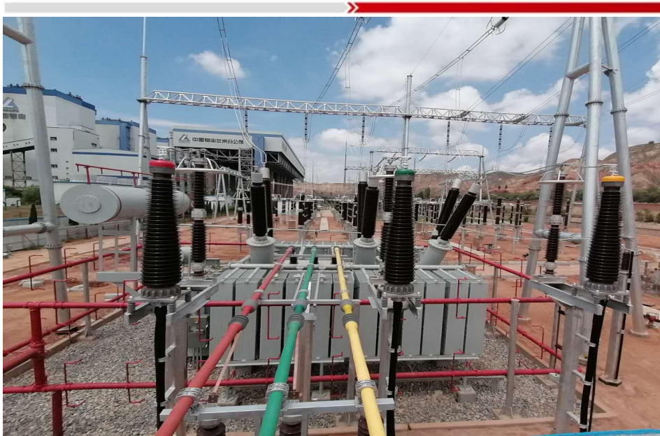
OSFPSZ11-360000/330电力变压器
