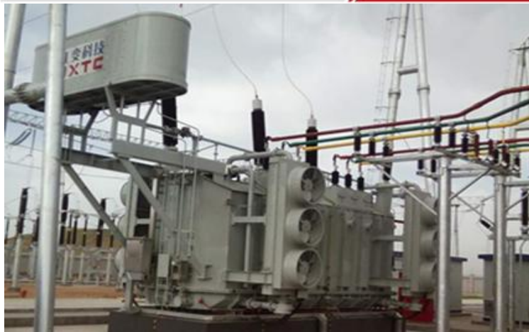
SFPFZ11-360000/220 轴向分裂 变压器宁夏宝丰集团光伏发电
