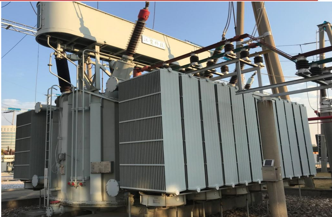
150MVA/220三圈有载调压高阻抗电力变压器(南昌供电公司艾湖变) 高-低阻抗: 47.7% 高-中阻抗: 12.2% 中-低阻抗: 33.7%
