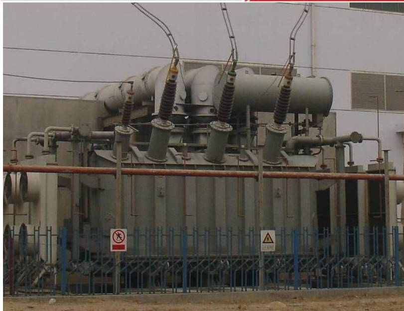
SFP10-250000/110 电力变压器 (登封电力集团有限公司热电厂)
